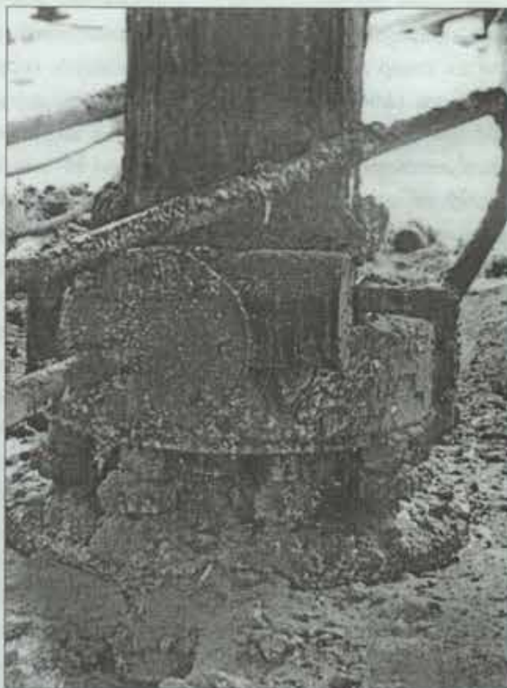
Устье той же скважины после применения разработанной ухтинскими учеными «Парождикостной системы охлаждения приустьевой зоны скважины в условиях многолетней мерзлоты».
