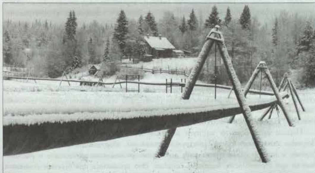
Подвесной газопровод вблизи Войвожа.
